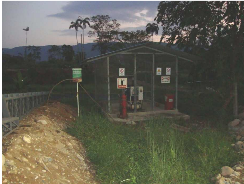
Fotografía 8.1.2-1 Generador de Emergencia, Campamento Mirador
